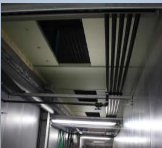
Figuur 7 Openingen waardoor verse lucht via de gang naar de kanalen gaat
