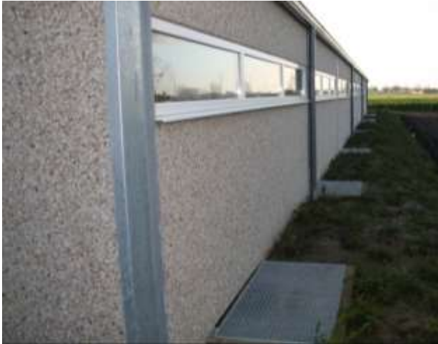
Figuur 4 Luchtinlaat bij kanaalventilatie (ondergronds)
