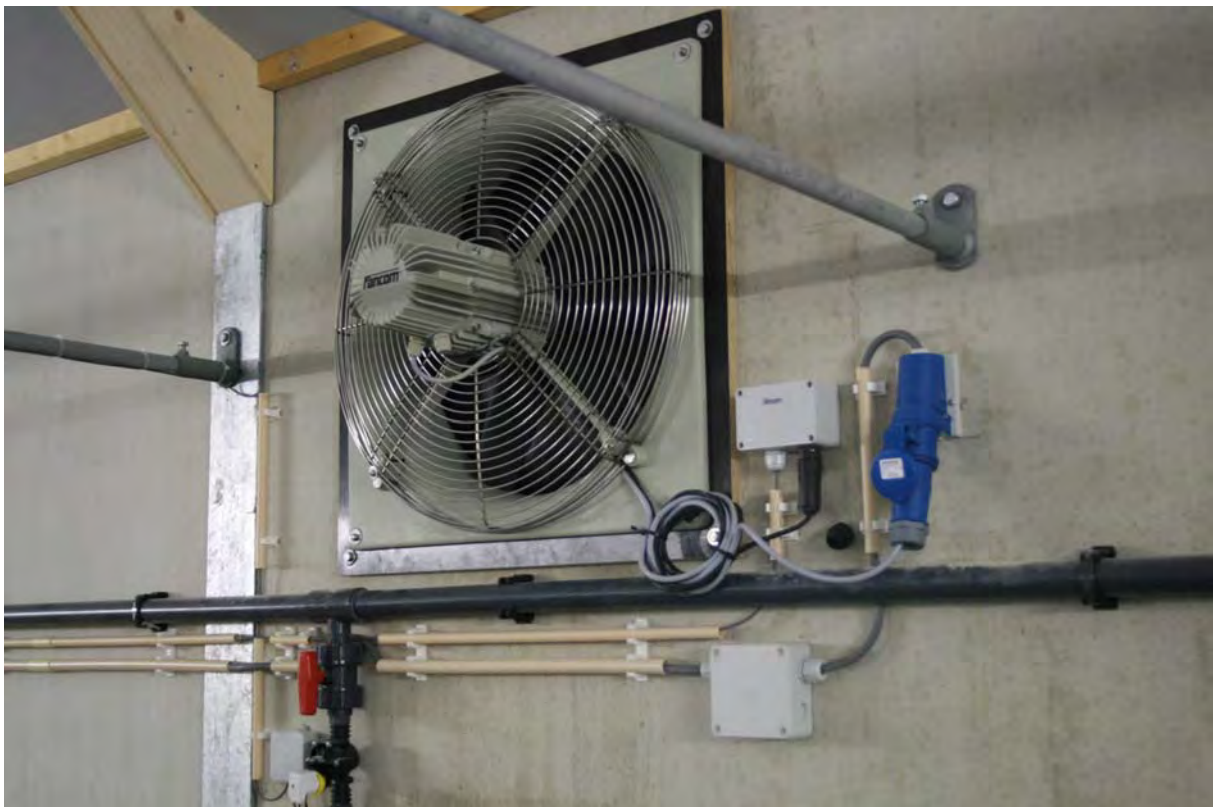
Figuur 44 Mengventilator in de afdelingswand
