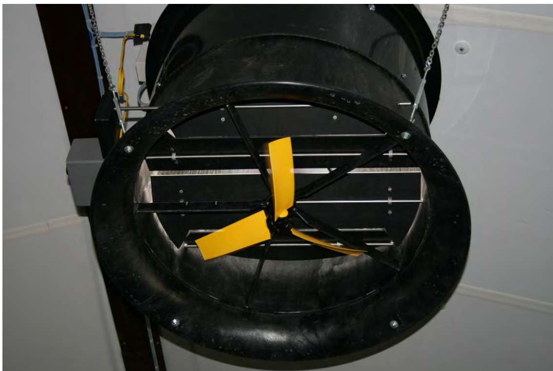
Figuur 11 Ventilator met meetwaaier en smoorklep
