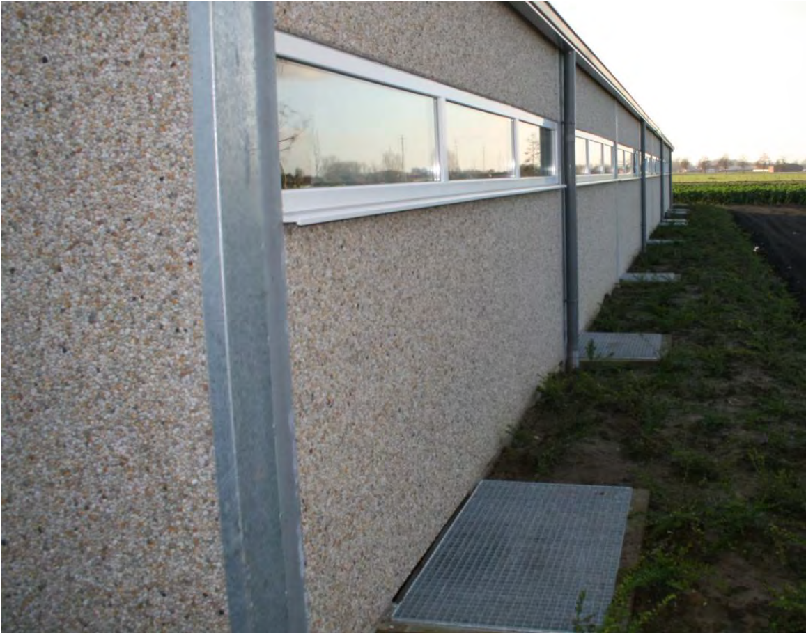
Figuur 36 Luchtinlaat bij kanaalventilatie (ondergronds)
