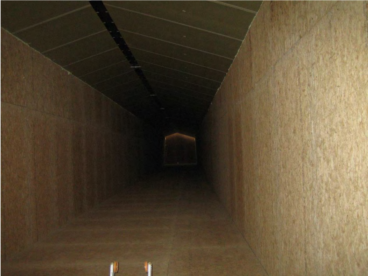
Figuur 39 Centraal afzuigkanaal
