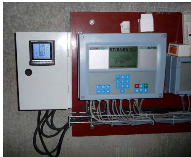
Figuur 7. Registratie van het energieverbruik voor ventilatie van een biggenstal (W-Vla) d.m.v. een energielogger (links).
