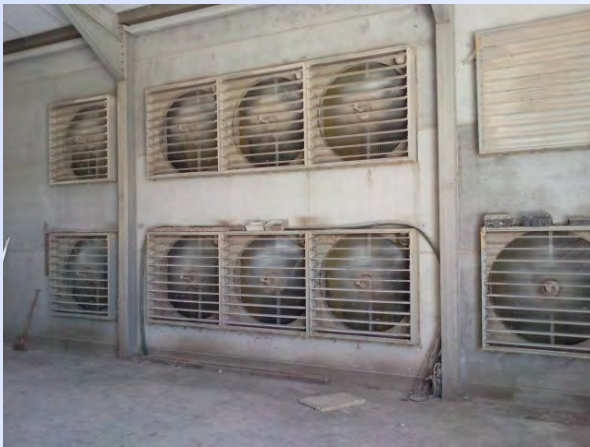
aanvullende ventilatiegroep en meter
