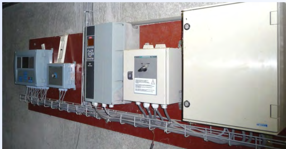
De ventilatiecomputer en elektrische installatie in de centrale gang (onder).
